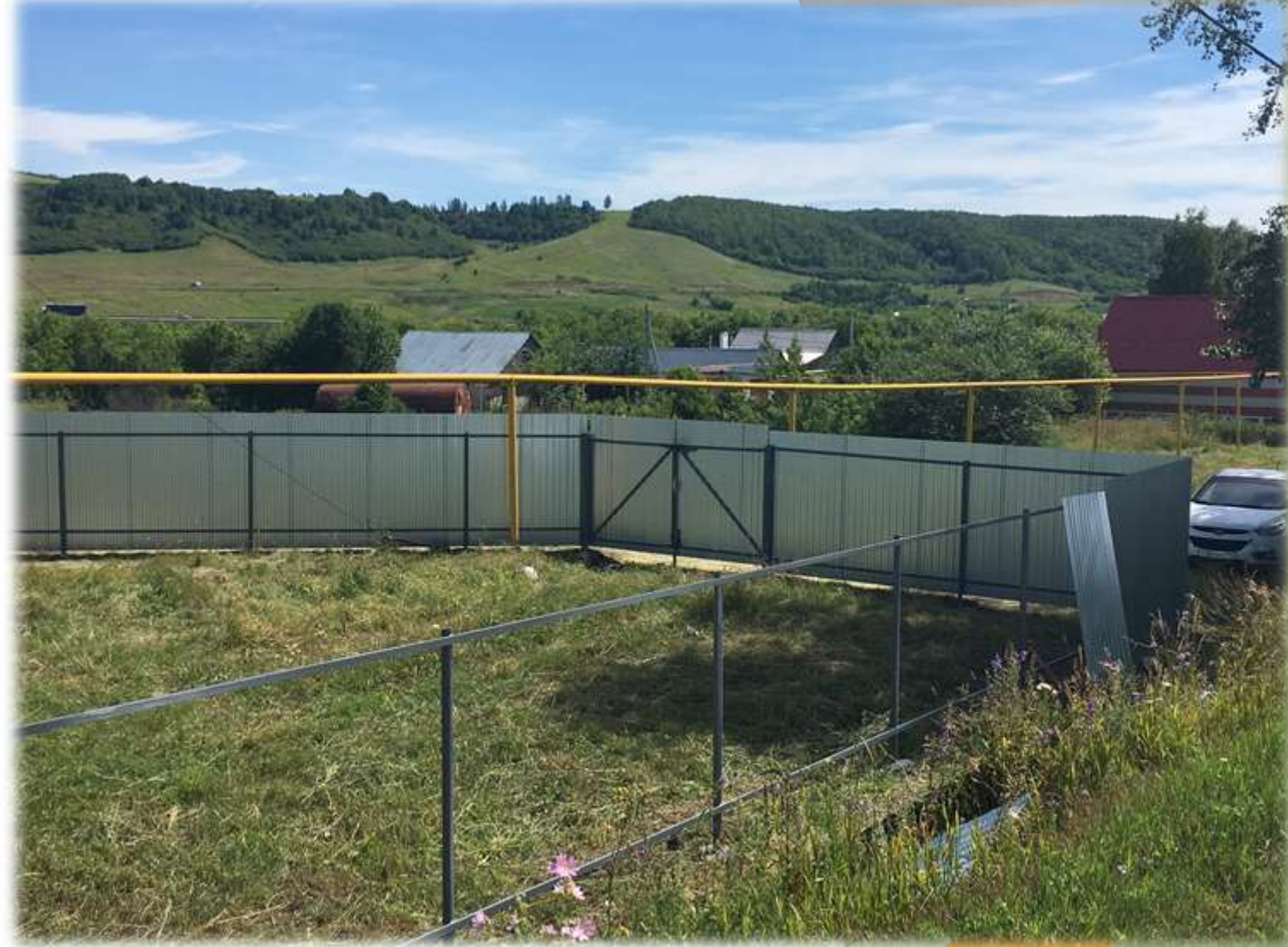
Ограждение водозабора по ул.Центральная в с.Русское Макулово
